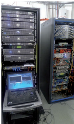
Le Datacenter, centre nerveux d'Alpha Direct Service
