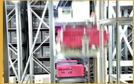
Le système a été pensé pour assurer la maintenance des navettes puisque chacune d'entre elles est indépendante
