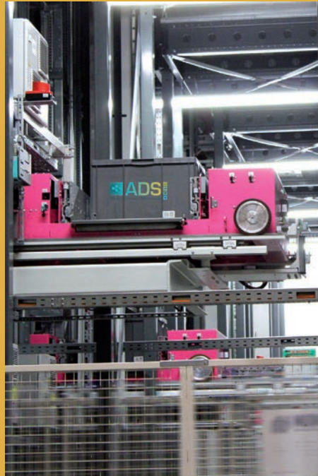
ADS a entièrement conçu le système de pilotage des navettes dans le magasin automatique
